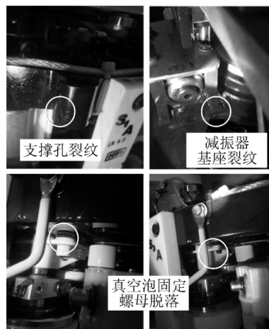
图11 切换开关减振器附近裂纹等缺陷
