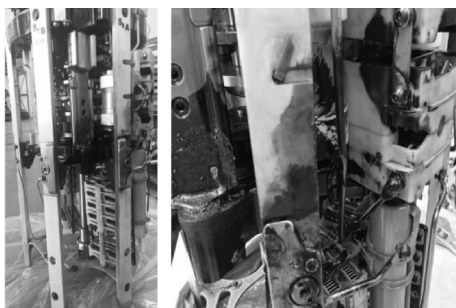
图1 某起换流变真空有载分接开关故障
